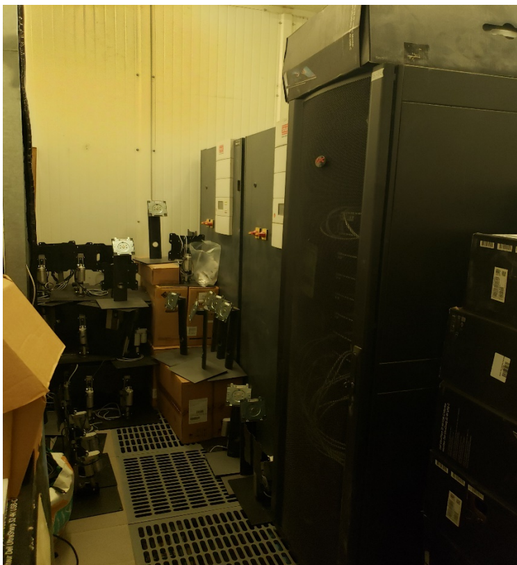
Figura 14 Área de Comunicaciones Existente - CIO&G División Mina Ministro Hales
