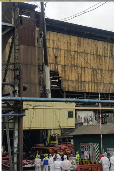
Figura 12 –Ejemplo montaje sala eléctrica
