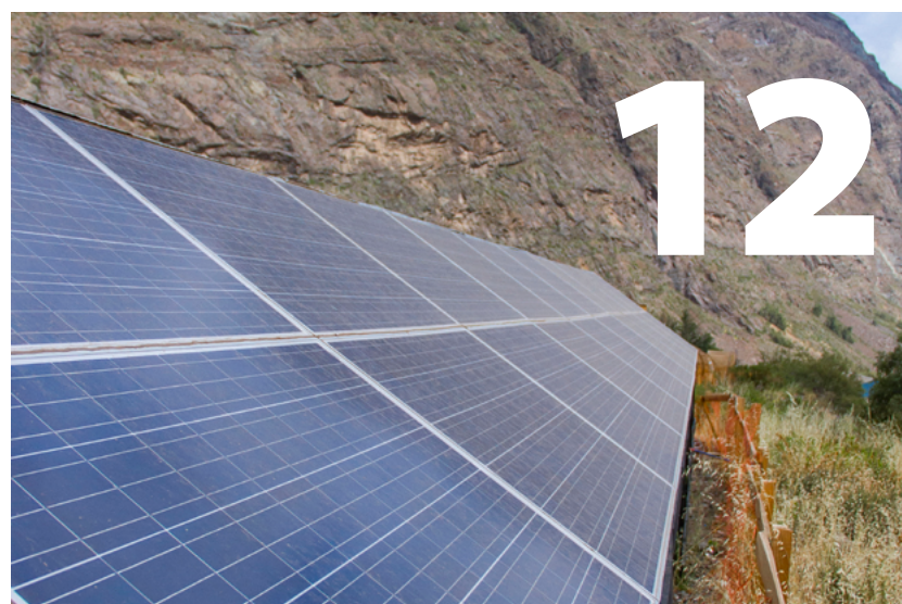
Paneles solares fotovoltaicos en el kilómetro 7
