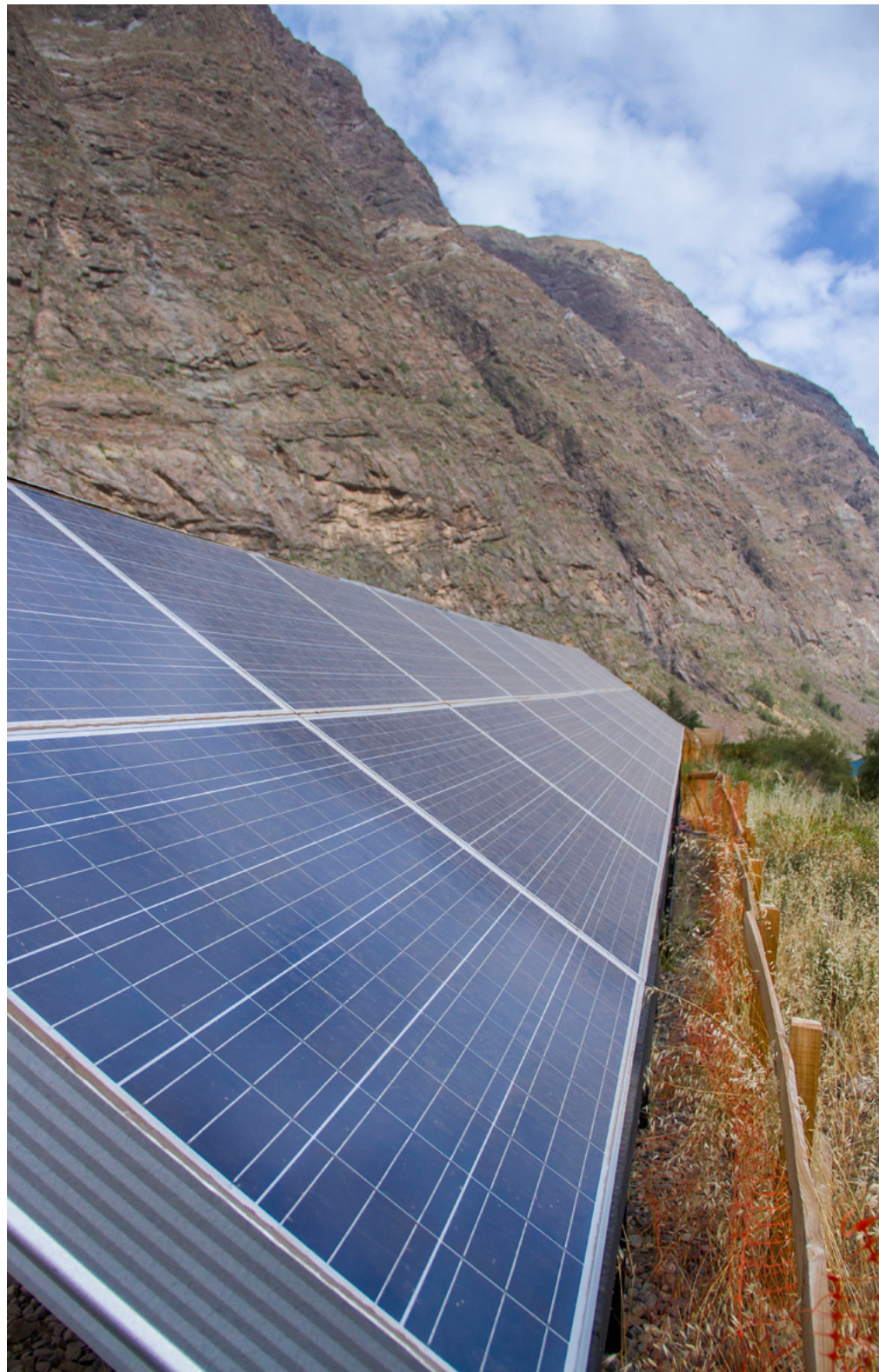
El proyecto consideró la instalación de dos paneles solares.
