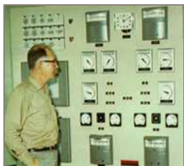
Salas de Control de paneles
