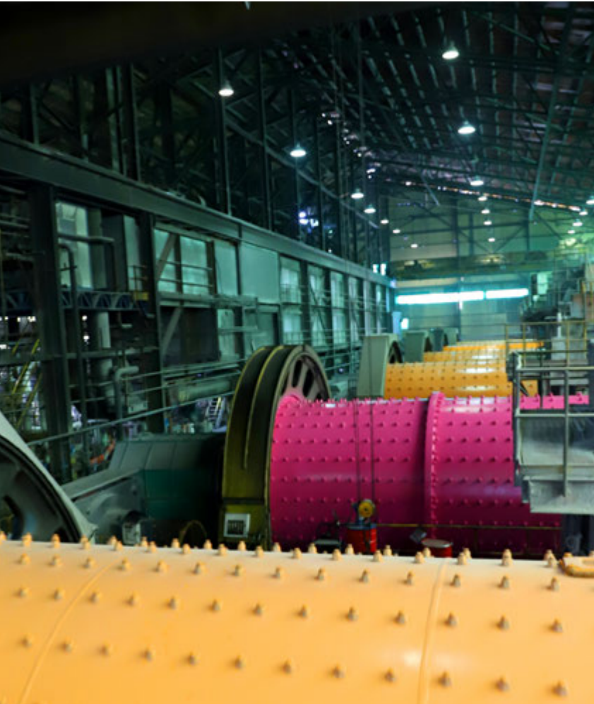
Instalaciones y operaciones en la molienda convencional de la Planta Colón Bajo en El Teniente.
