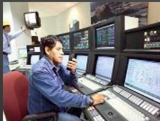
Sala de Control 3
