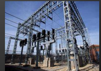
Planta de Energía
