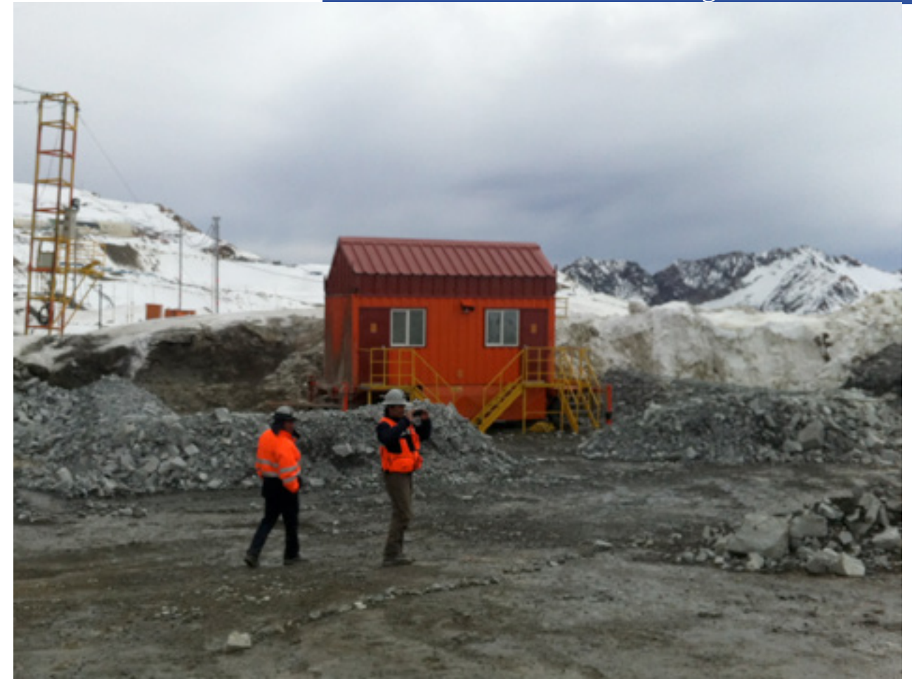
El proyecto debió contemplar variables como temperatura, clima y desarrollo de la mina.
