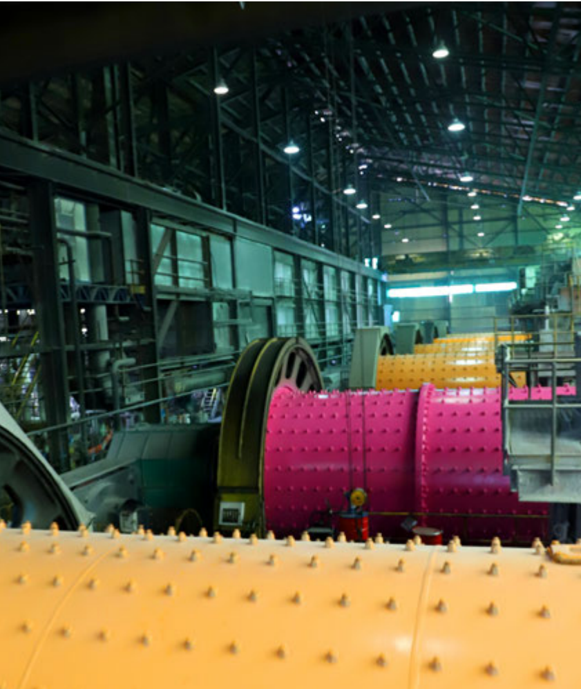
Instalaciones y operaciones en la molienda convencional de la Planta Colón Bajo en El Teniente.
